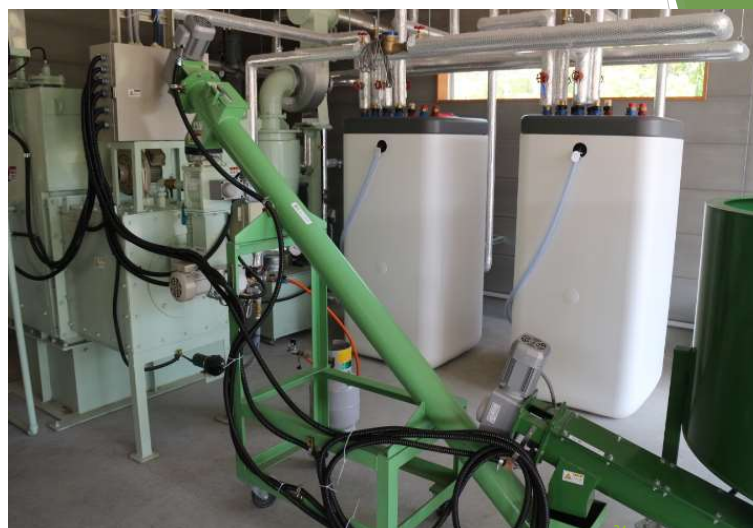
貯湯タンク（熱交換タンク）
