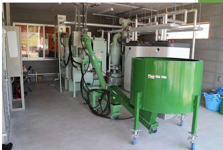
バイオマスボイラーシステム全体
