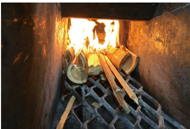
ボイラーでの燃焼状況
