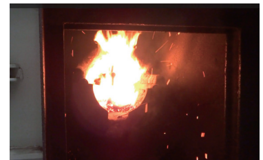
竹チップ燃料が燃焼しているボイラー
